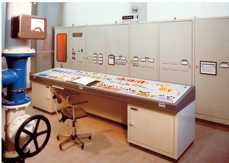
Abb. 2.2: Bedienungsstation einer Spülwasserkreislauf- und Abwasserbehandlungsanlage aus dem Jahr 1969
